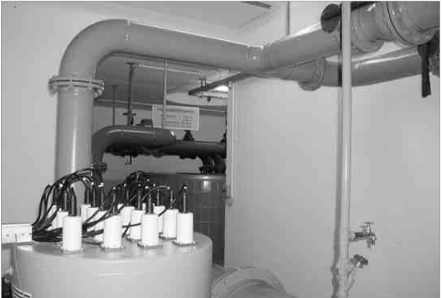
Die UV-Anlage des Wasserwerkes Lauterach
