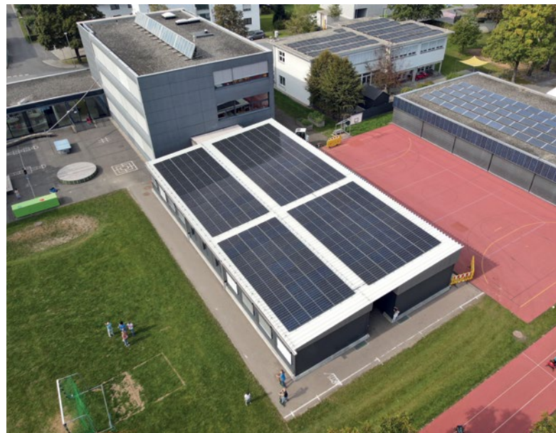
Neue PV-Anlage auf den Modulen der Schule Unterfeld
