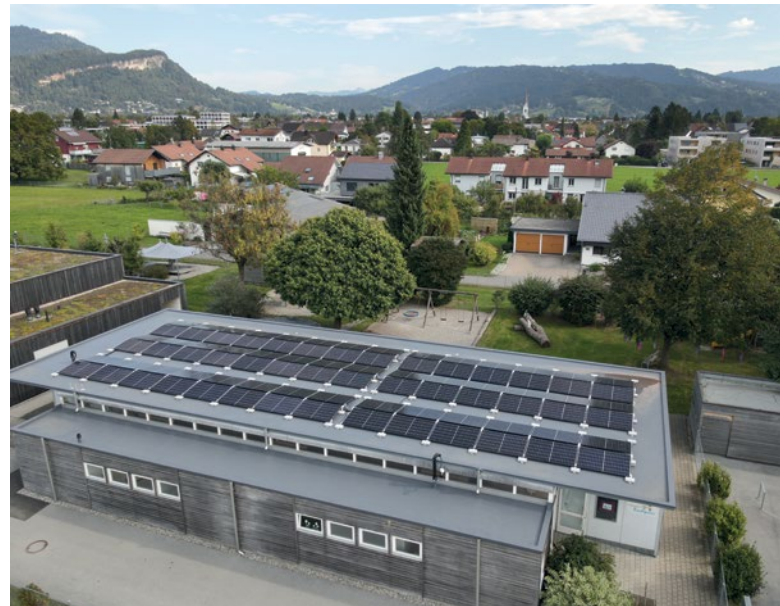
Neue PV-Anlage auf dem Kindergarten Bachgasse
